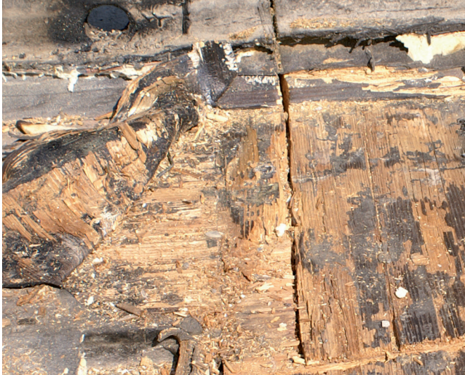
Abb. 3: Schadensbild Sekundärkondensat durch Restfeuchtverlagerung
